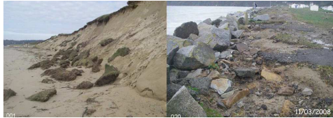
Figure. Dégâts suite à la tempête Johanna (DDTM50)
