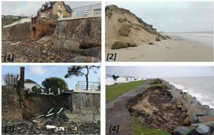
Figure. Dégâts suite à la tempête Eleanor (DDTM50)
